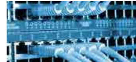
Réseaux de télécommunication et de vidéocommunication
